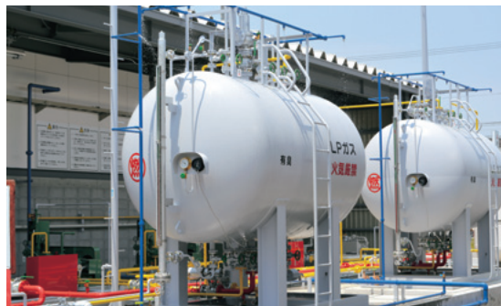
回収LPガス貯蔵タンク
