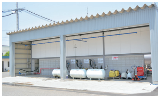
ガス回収施設
