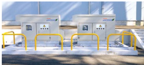
LPガス自家発電装置
