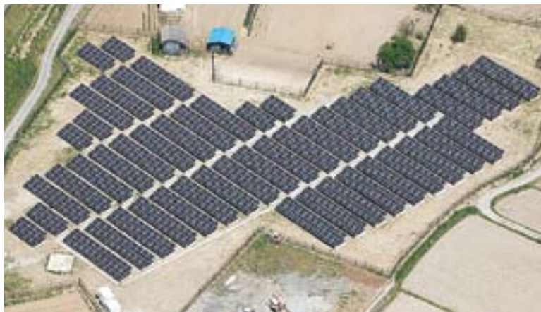
自社物件第4号 サンリン千曲発電所
