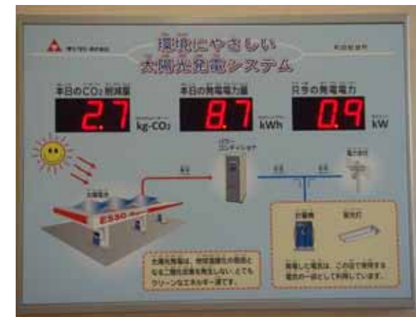
事務所内の発電量表示機器
