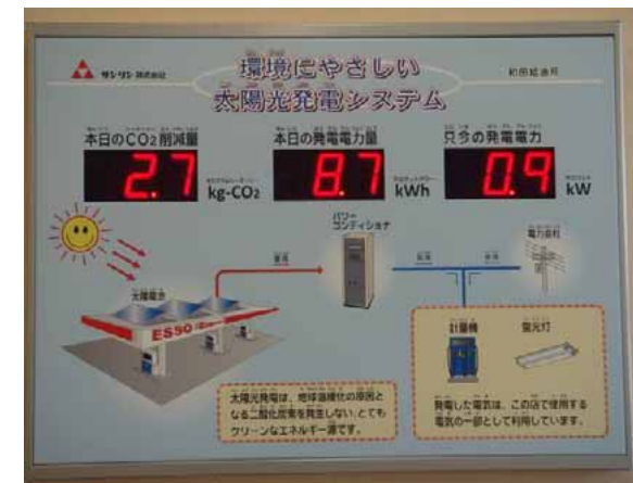
事務所内の発電量表示機器
