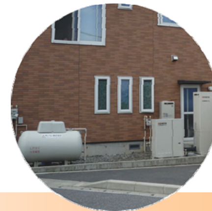
家庭用燃料電池エネファーム
