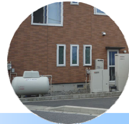
家庭用燃料電池エネファーム
